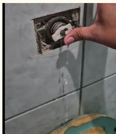
Figura 15 CT - Cuiabá/MT. 3º Conselho Tutelar de Cuiabá. Detalhe do vazamento na descarga do banheiro.
