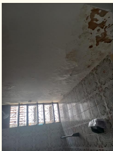
Figura 10 Natal/RN. Conselho Tutelar Região Oeste. Detalhe do teto com infiltração e mofo.
