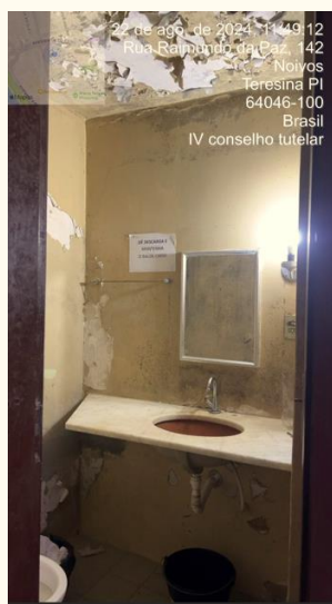
Figura 11 Teresina/PI – IV Conselho Tutelar de Teresina. Banheiro em situação precária.
